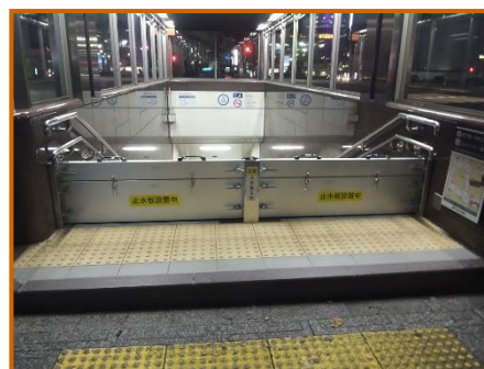
南北線仙台駅に配備した止水板
