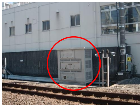
駅補助電源装置
