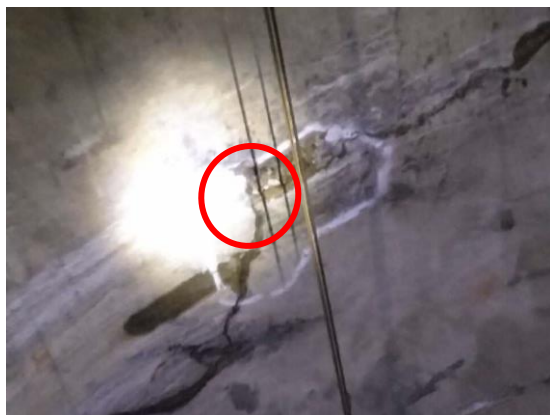
落下していた箇所
