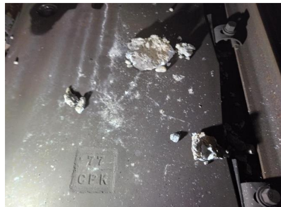
落下していたコンクリート片
