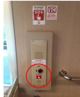
車内通報装置
