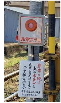
押ボタン式踏切支障報知装置
