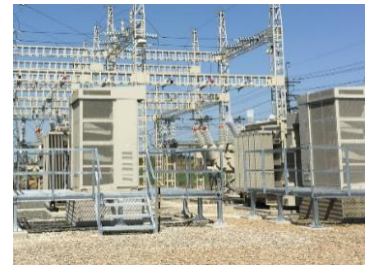
△変電所機器 (参考: 静和変電所)
