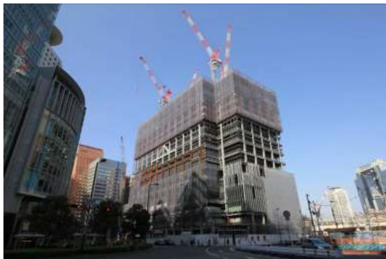
左：外観イメージ（JR大阪駅前から）、右：建設工事の様子（2022年3月16日時点）
