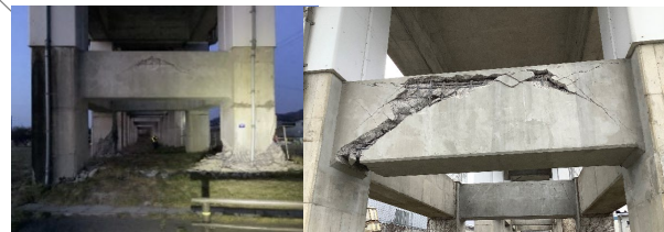
土木設備損傷(高架橋)
