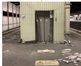
駅設備破損(福島駅)
