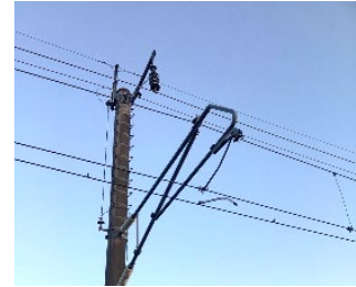
架線金具等の損傷
