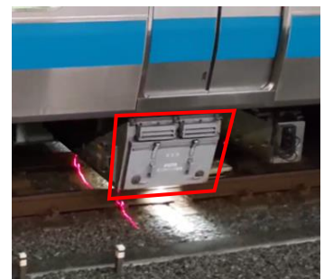
線路設備モニタリング装置
