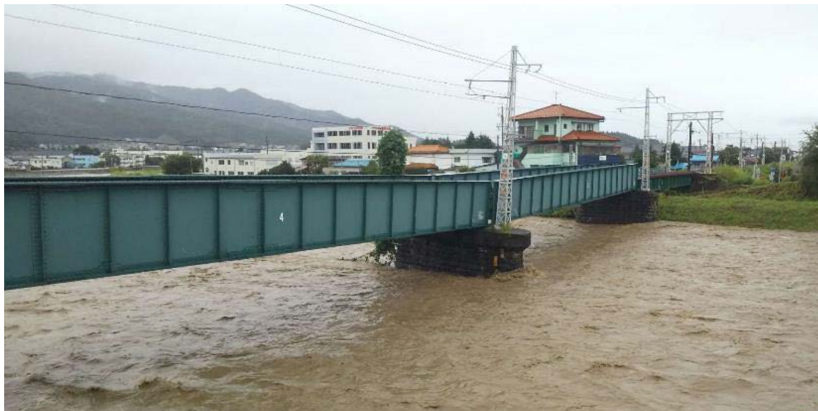
飯田線 (宮木駅～辰野駅 橋脚等の損傷)
