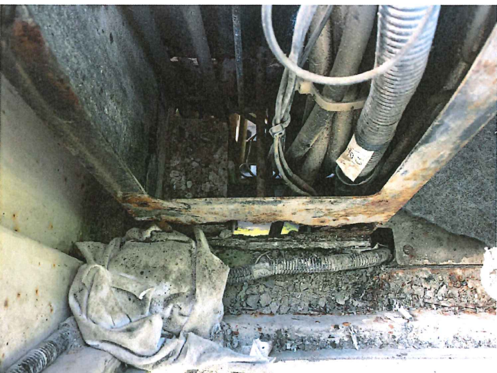
⑤腐食例 右レバースタンド腐食状況
