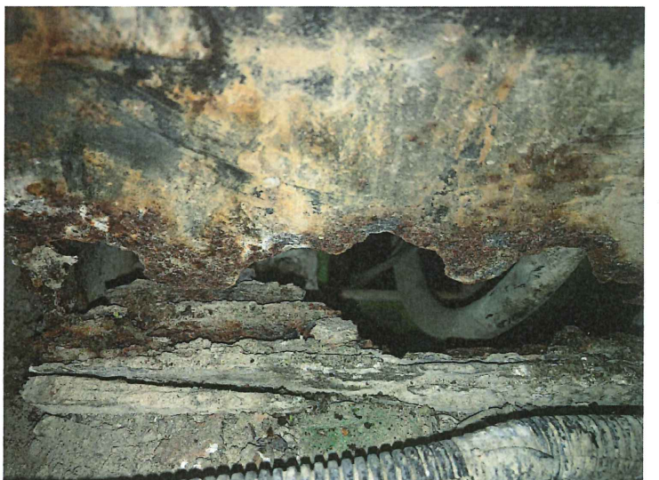
⑥腐食例 右レバースタンドアースポート取付部欠落状況
