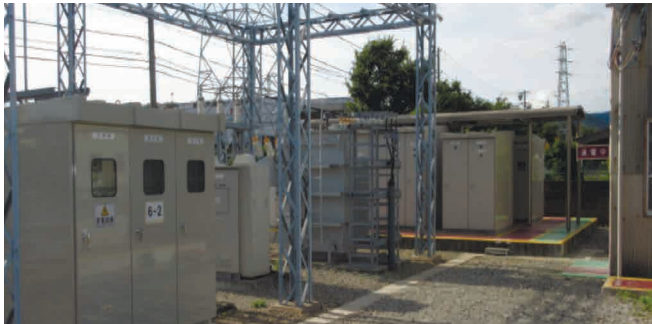
受電設備の更新
