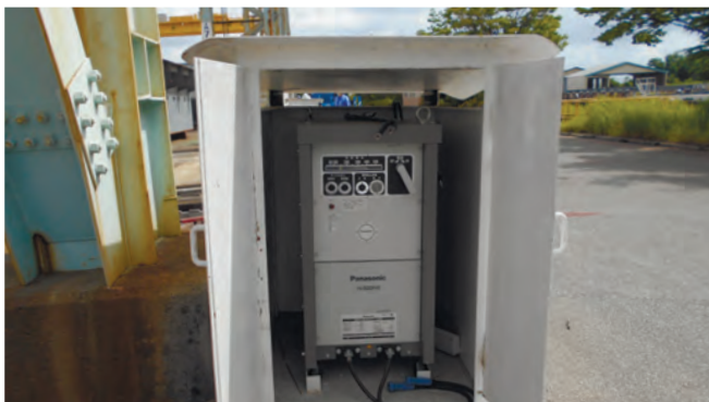
アーク溶接機の更新
