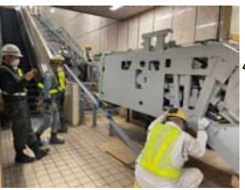
3 階段にレールを設置し、設置場所まで部品を移動させます。骨組みなど大きな部品は、分割して運ぶこともあるそう。
