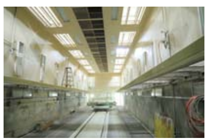
車両基地内には「塗装ブース」を完備。10年に1度の検査期間中に、車両の塗装補修も行っていきます。
