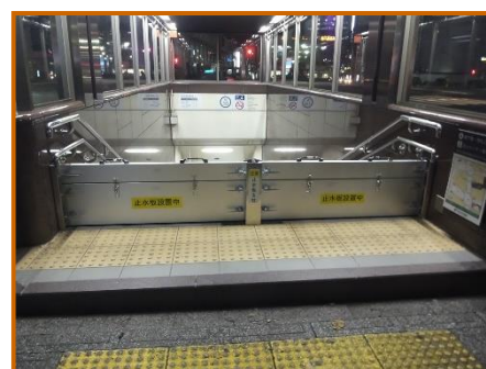
南北線仙台駅に配備した止水板
