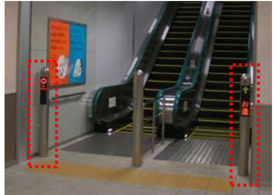
写真④ ポール式案内装置
