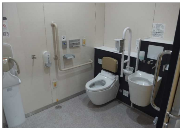
③ ひろびろトイレの利用集中を分散するため、車いすの方、オストメイトの方もご利用頂ける便房を男女トイレ内に各1ヶ所設けました。
