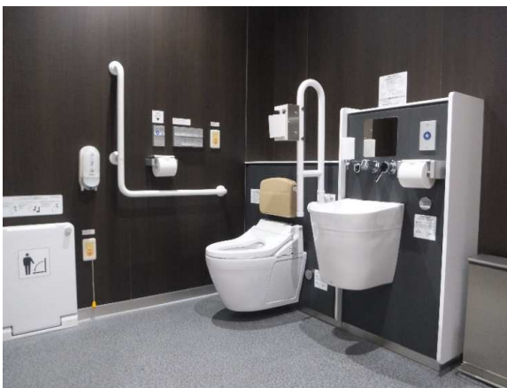
② ひろびろトイレの利用集中を分散するため、車いすの方、オストメイトの方もご利用頂ける便房を男女トイレ内に各1ヶ所設けました。
