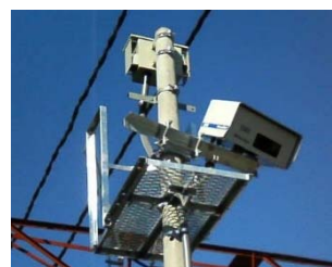
踏切障害物検知装置の整備
