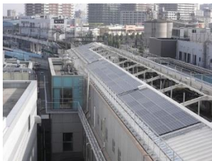
▲太陽光発電システム（南千住駅）
