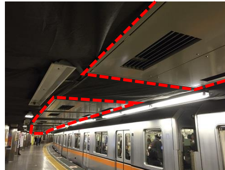
駅冷房設備整備の例
