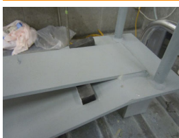
① 充填範囲(2~3cm程度)の2面に硬質スポンジ型枠を設置する。
