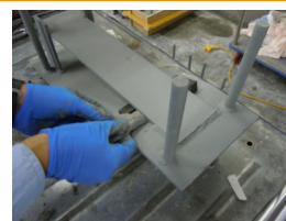
③ 袋先端を充填箇所に挿入し、絞り出しながら充填する。
