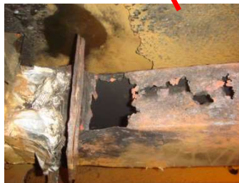
床下排気管腐食
