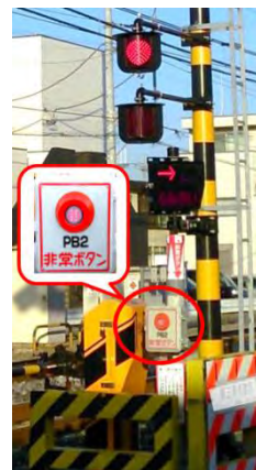
踏切安全対策
