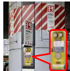
非常停止ボタン
