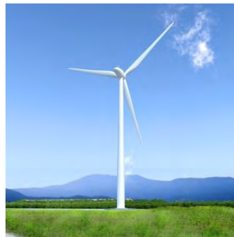
風力発電設備
