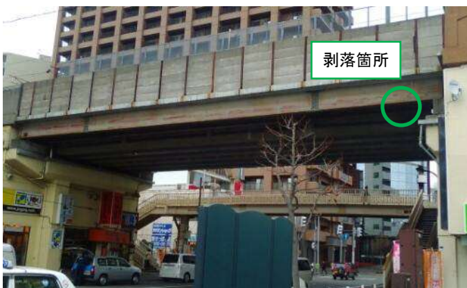
【写真 1 剥落箇所】
