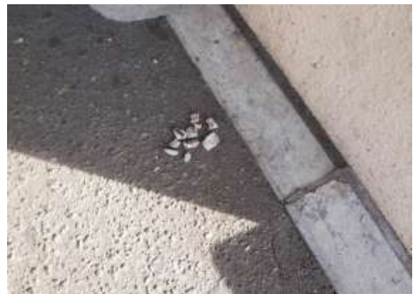
【写真 2 剥落したコンクリート片】
