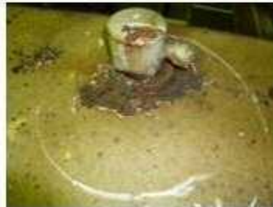
屋根構体腐食
