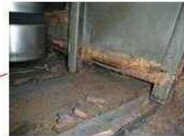
便所内部腐食
