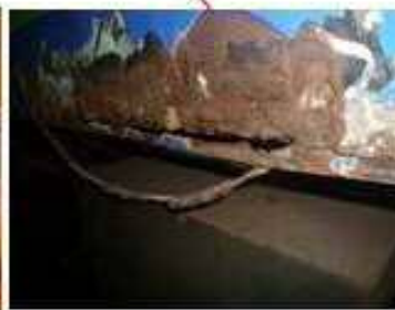
側構体部腐食
