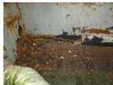
水タンク内部腐食
