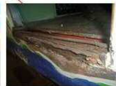
側引戸部腐食
