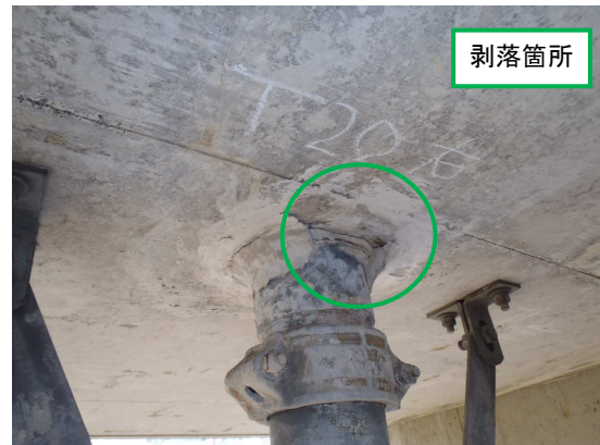
【写真 2 剥落箇所詳細】
