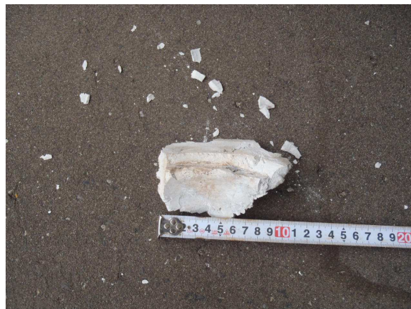
【写真 3 剥落したモルタル片】
