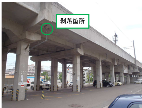
【写真 1 剥落箇所全景】
