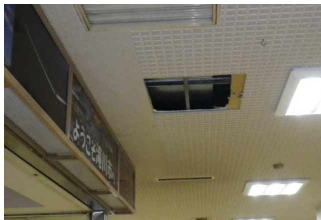
天井材落下部分
