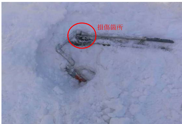
損傷した配管（拡大）①
