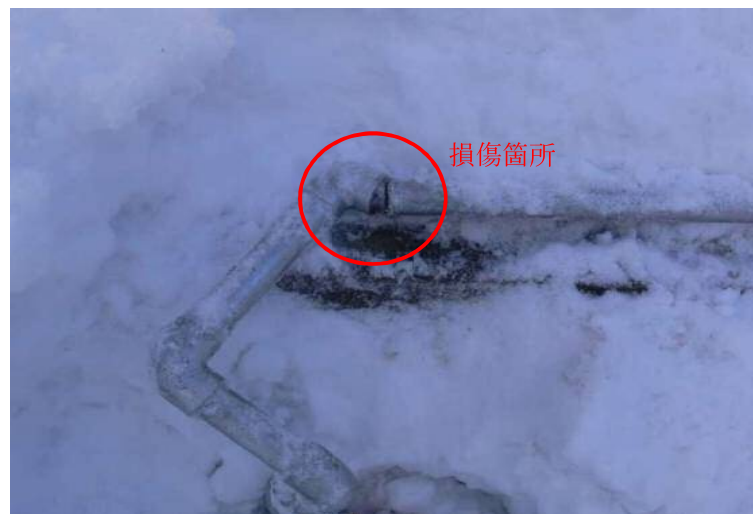
損傷した配管（拡大）②
