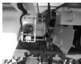
図14 軌間内散布監視カメラ
