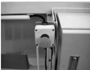
図16 緊急停止ボタン
