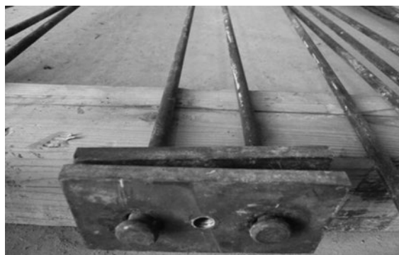
図6 PC鋼材の状態
