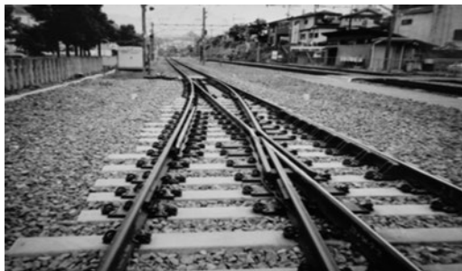
図8 中央本線大月構内PCまくらぎ使用の分岐器
