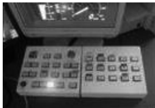
図3 事象発生用スイッチボックス
