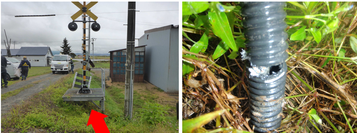
切断していたケーブル
