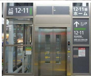
エレベーター
