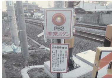
踏切支障報知装置
