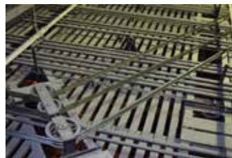
吊物電源装置不具合
