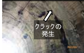
覆工コンクリートの劣化・剥落
