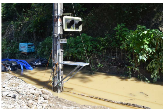
吾妻川からの土砂の流入状況
