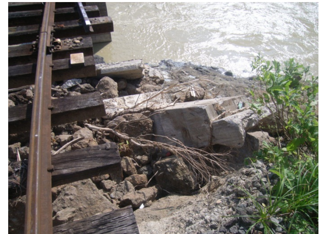
橋台倒壊状況
