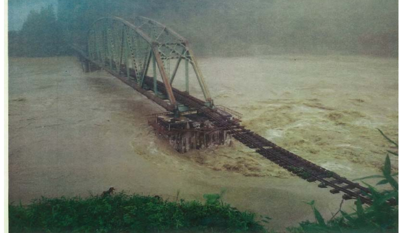
《被災直後》 1径間(約25m)流失
