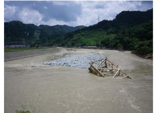
橋桁流失状況
