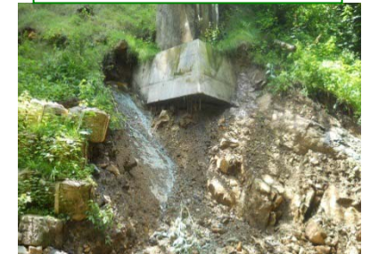
52k520m付近 羽根沢橋りょう洗掘
