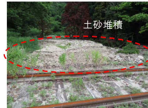
沢からの土砂堆積、土砂流入 (深沢橋りょう)
