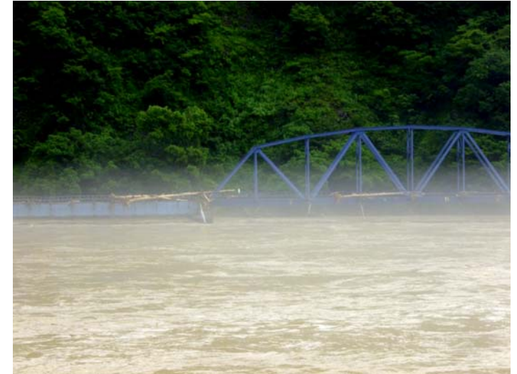
《被災直後》 第8只見川橋りょう部
