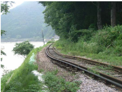
盛土地滑りによる線路沈下
