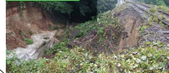
30k700m付近 盛土崩壊
