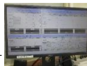
各部署に設置された監視端末
