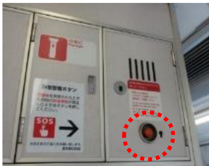
車内に設置してある非常警報ボタン
