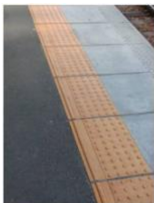
内方線付き点状ブロック
