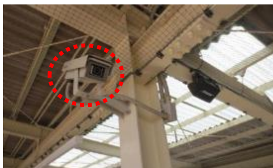
駅構内に設置した防犯カメラ
