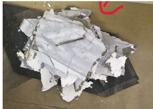
写真2 落下した石膏ボード
