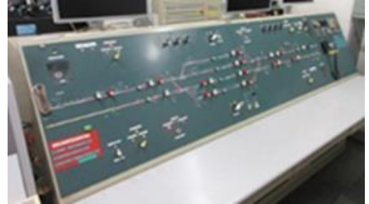
連動制御盤 (新横浜駅) ※不動産 (新幹線まるごとショップ)
