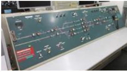
連動制御盤（新横浜駅）※不動品 （新幹線まるごとショップ）
