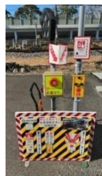
【踏切報知ボタン】
