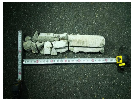
落下していたモルタル片
