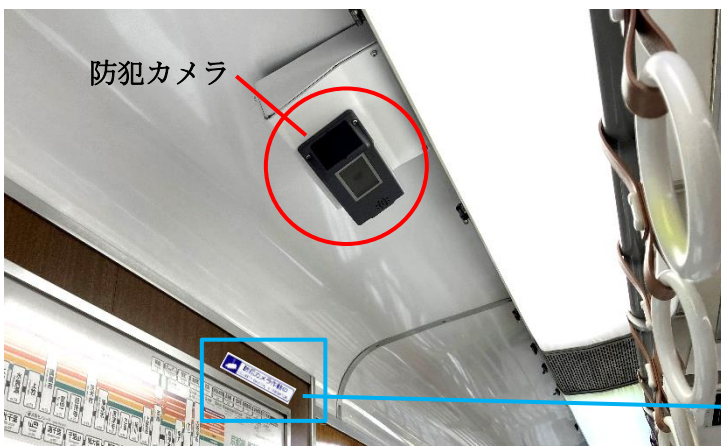
防犯カメラの設置イメージ（乗降ドアの上部）
