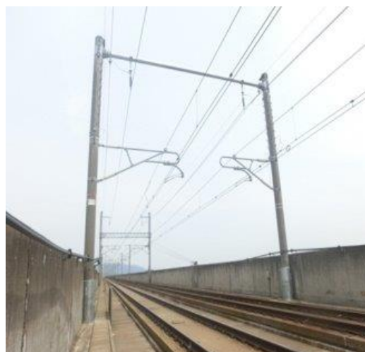
電化柱（高じん性化）
