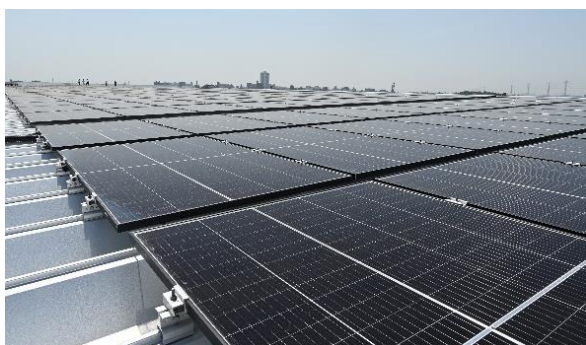
東武商事が設置した太陽光発電所 (埼玉県春日部市)
