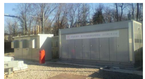
【リチウムイオン電池式電力貯蔵装置】
