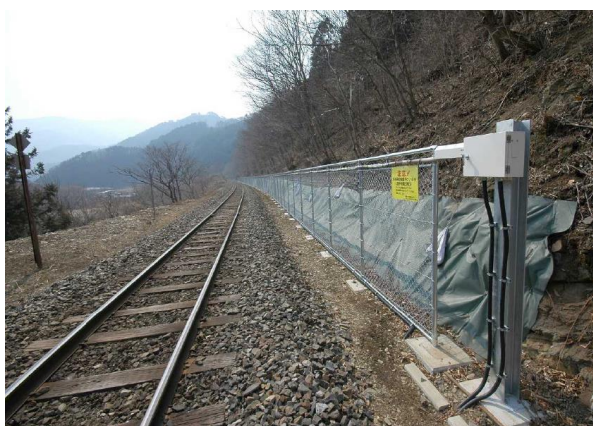
落石検知装置
