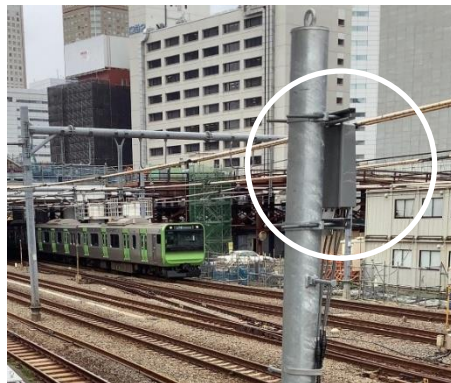
高輪ゲートウェイ駅～品川駅間 5G アンテナ（囲み丸部分）
