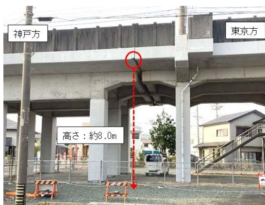
落下した箇所
