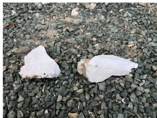
落下していたモルタル片（2片）
