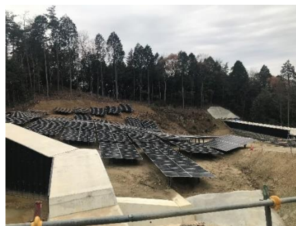
瀬戸太陽光発電所（愛知県）
