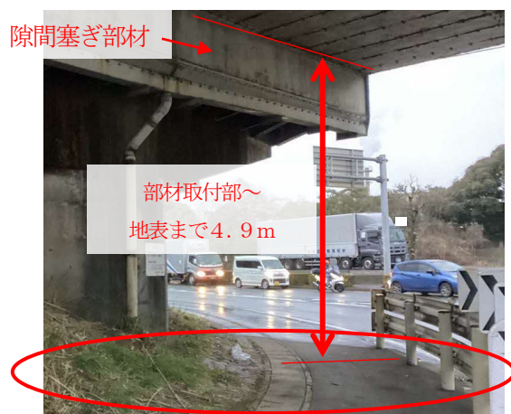
落下箇所全景
